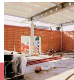
Mit Variotherm System-W ausgestattetes Büro- und Produ In den Sommermonaten wer Kühlungen eingesetzt. Zu dies kaltes Brunnenwasser r ausgelegten Plattenwärmeta
